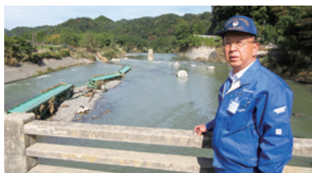
▲台風第19号により、久慈川に架かる水郡線の橋脚、橋げたが流された。大子町内にて。(R1.10.17)
