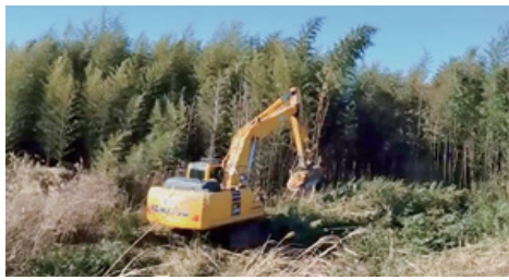
▲涸沼川の竹伐採が、土師、住吉、湯崎地区で進められている。（R5.1月）
