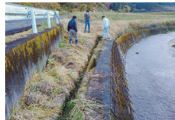
▲本戸地区の南指原川から取水する用水路の補修依頼が区長さんたちからあり、現地調査。県土木部により、直ちに工事が完了した。(R4.11月)
