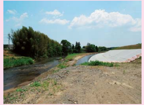
▲橋爪地区の酒沼川の流れを良くする工事をしています。①河川整備と、②県道大洗友部線の拡幅と、③穴戸橋の架け替え、私が進めている三点セット整備の一環です。
