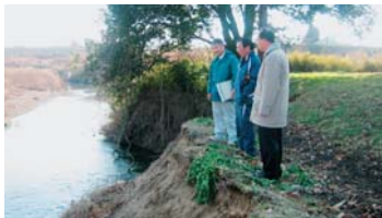
▲土師地区の潤沼川の浸食状況を石崎区長と調査。水戸土木事務所がすばやい対応してくれた。(25年1月)
