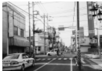
▲友部駅前通り(県道平友部停車場線)の改修工事が始まった。「福祉の町友部」の玄関口にふさわしい道路・歩道として整備するもので、常井議員が一般質問で取り上げた。地権者の皆さんのご協力により、民地への電柱移設工事が進んでいる。(14年4月)
